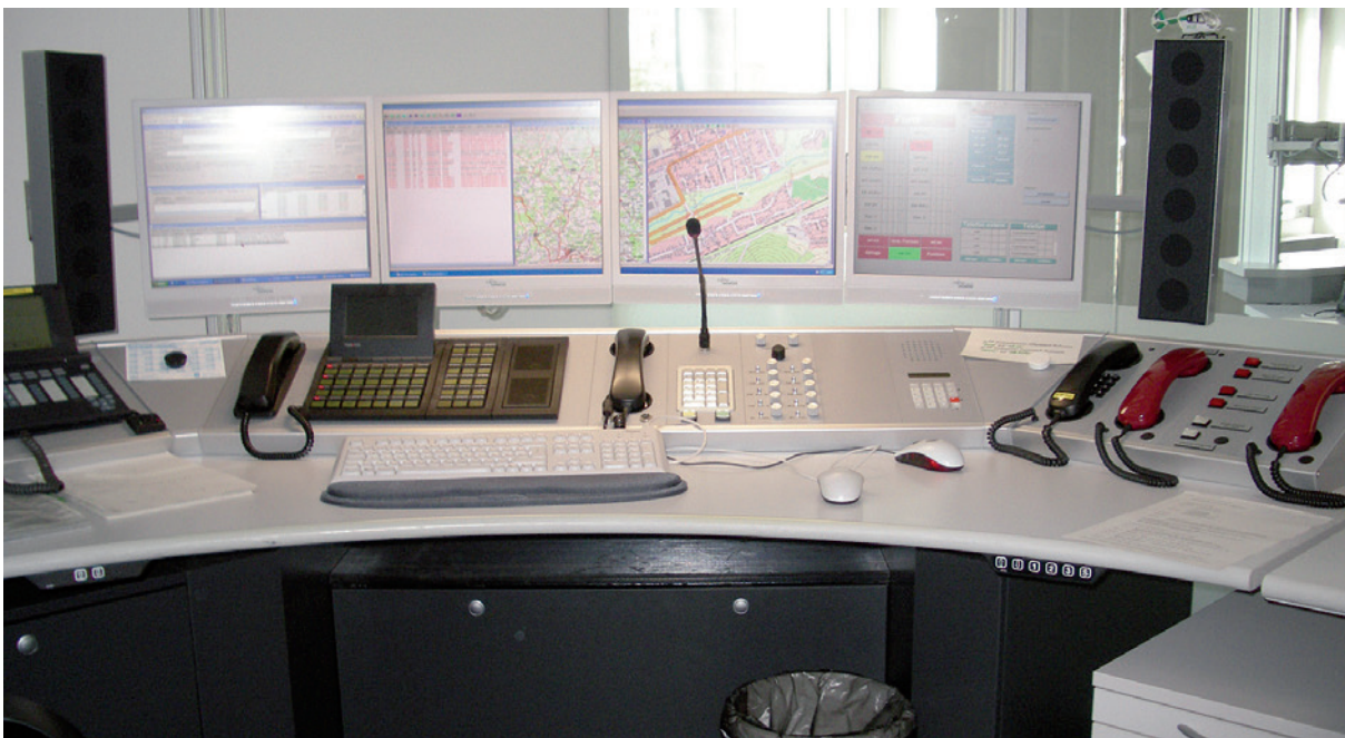
Notruf- und Serviceleitstelle (NSL)
